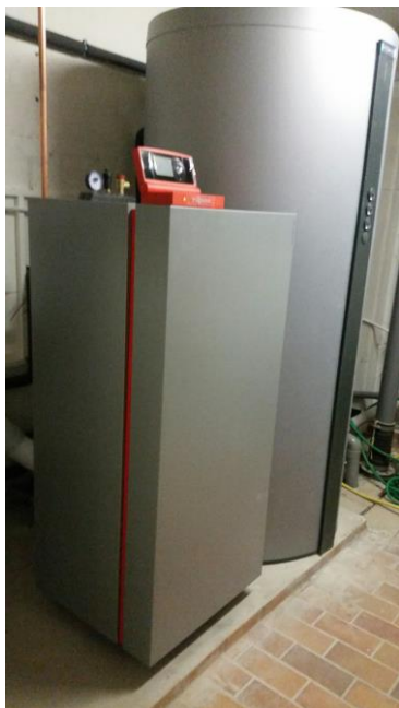
Die neue Heizung nimmt ihren Dienst auf
